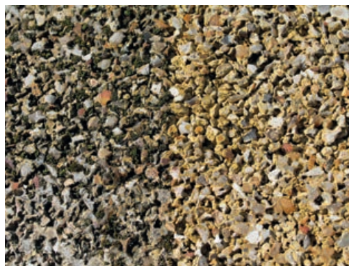
Photo 98 - Aspect du béton drainant avant nettoyage (partie gauche) et après nettoyage (partie droite).
