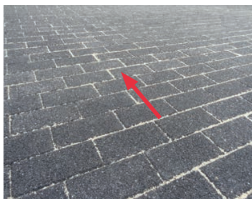
Photo 77 - Appareillage à lignes de joints discontinues dans le sens principal de la circulation.
