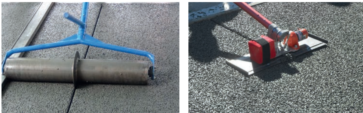
Photos 59 et 60 - Exécution des joints dans le matériau frais à l'aide d'un rouleau jointeur (à gauche) ou d'une jointeuse vibrante (à droite).
